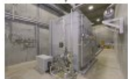
① バイオガス精製設備
