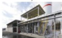
② 水素製造装置
