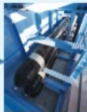
② 蓄圧器ユニット
