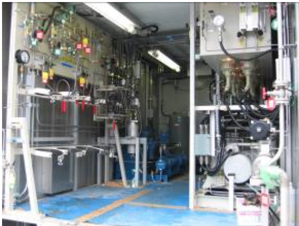
バイオガス精製充填装置
