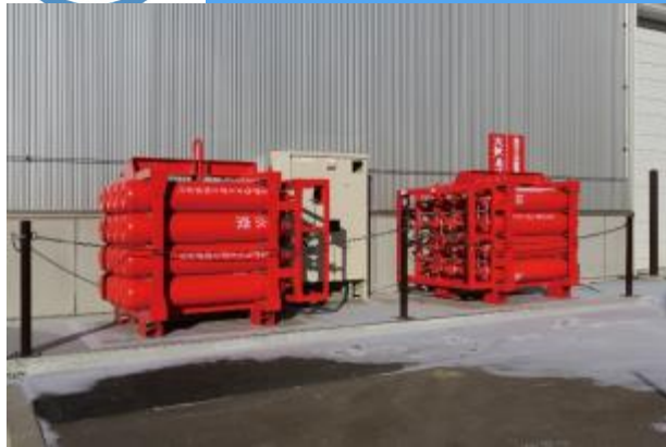
■ カードル置き場 16本組×2基：水素貯蔵量284Nm 3 (水素使用量：約240Nm 3 /10日間)
