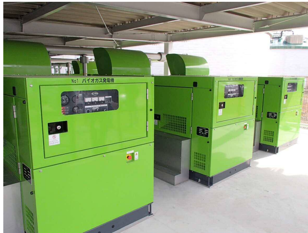
バイオガスエンジン (恵庭バイオガスパワー再生可能エネルギー発電所；水ingエンジニアリング(株))
